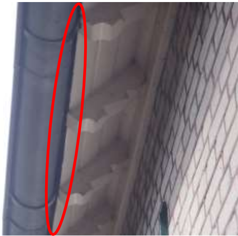
Foto 13: brede kier onder de dakgoot van de sluiswachterswoning die het voor vleermuizen mogelijk maakt om onder de dakpannen te komen.
