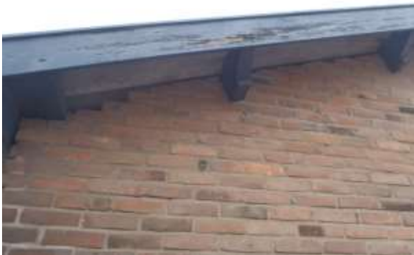
Foto 7: de rafelige spouwmuur van een lage loods. Via deze openingen is de spouw toegankelijk.
