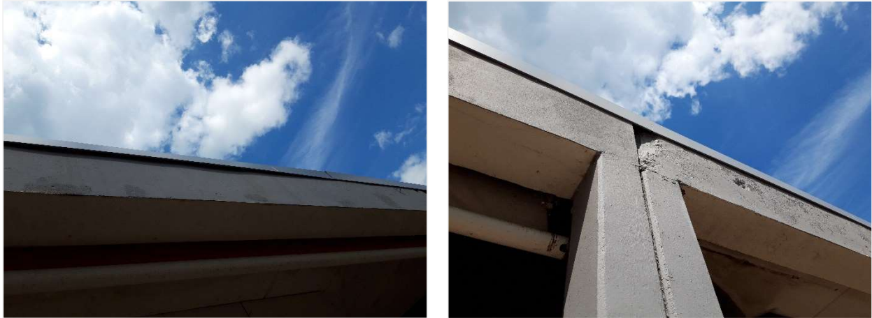
Figuur 3-1. Van linksboven naar rechtsonder: Pand voorzien van gevelbetimmering, twee delen met kierende daktrimmen en een afbrokkelende betonnen luifel waardoor kieren ontstaan. Foto's: RHDHV, 2021.
