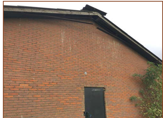
Afb. 2.3: Uitwerpselen tegen de zijkant van de te slopen stal. De hangende balken worden waarschijnlijk als rust- en uitkijkpunt gebruikt door de Boerenzwaluw.
