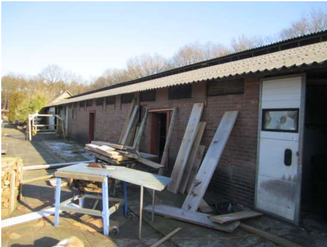
Foto 1. Eén van de af te breken stallen aan de Amersfoortseweg 287
